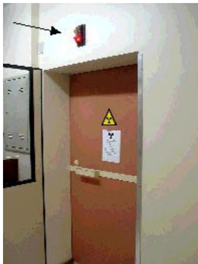
Figura 6. Porta da sala de tratamento. No destaque vemos o sinalizador com a luz vermelha ligada evidenciando que a fonte está exposta
