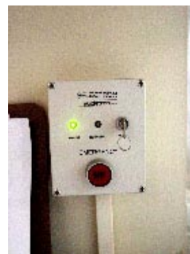
Figura 8. Botão de emergência
